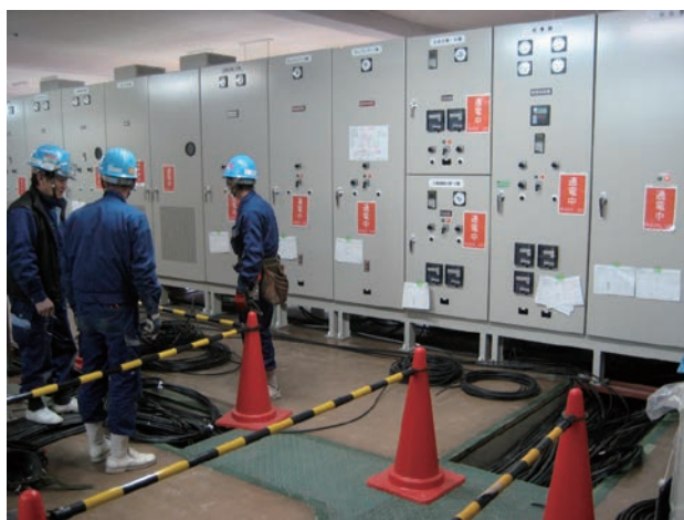
図5-7 更新が必要な電気設備
