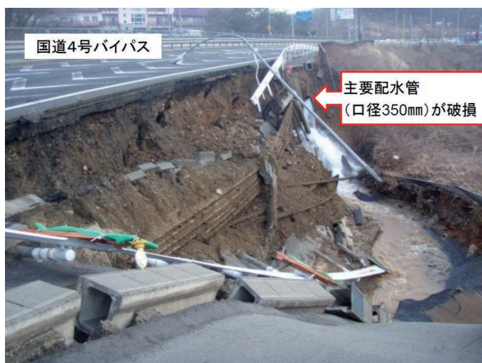
図4-5 東日本大震災において被災した水道施設（福島市水道局企画課提供）
