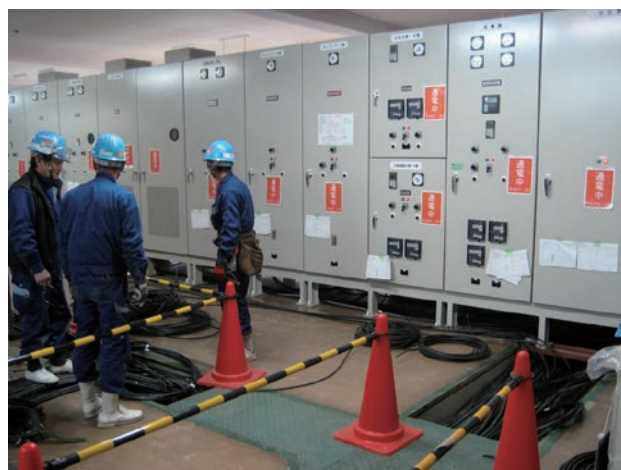
図5-7 更新が必要な電気設備
