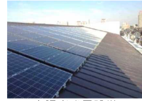
太陽光発電設備 (志津市民プラザ)
