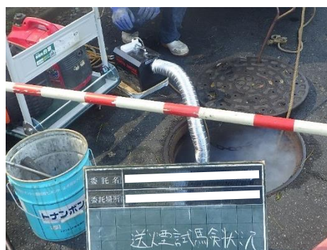
図4-13 不明水対策(送煙調査)
