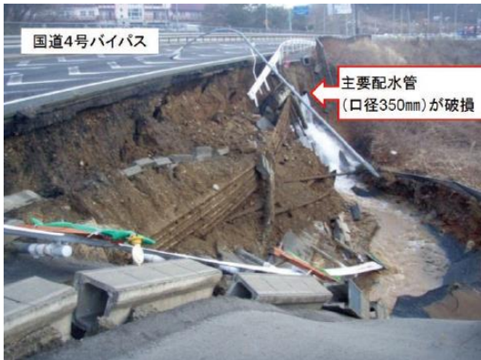
図4-4 東日本大震災で破損した水道管 (福島市水道局企画課提供)
