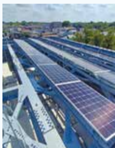
▲夢咲くら館に設置された太陽光パネル
