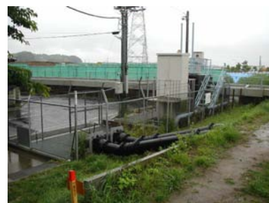
排水ポンプ施設
