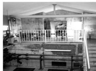
下水道ポンプ場
