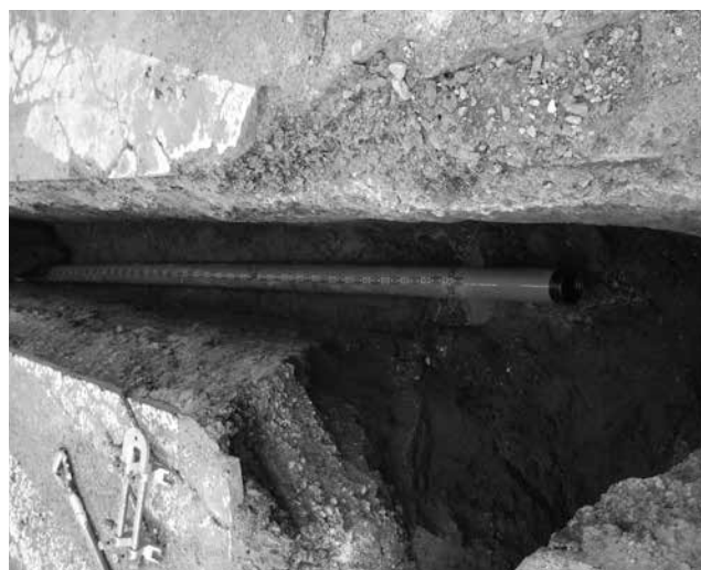
上水道耐震管
