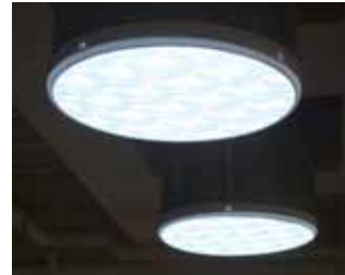
自然光を集光する 光ダクトによる採光で 室内は照らされている
