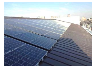
太陽光発電設備 (志津市民プラザ)
