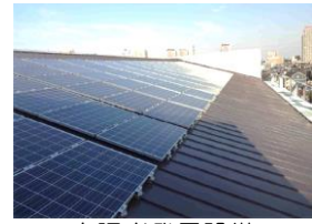
太陽光発電設備 (志津市民プラザ)
