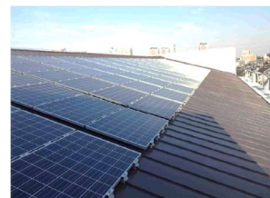
太陽光発電設備 （志津市民プラザ）
