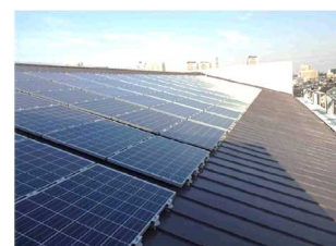
太陽光発電設備 （志津市民プラザ）
