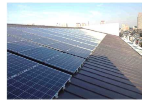
太陽光発電設備 (志津市民プラザ)
