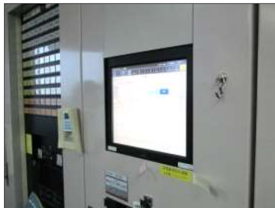
市立美術館の BEMS (ビルエネルギーマネジメントシステム)
