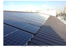
太陽光発電設備 (志津市民プラザ)
