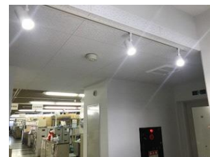
LED照明 (本庁舎1号館)
