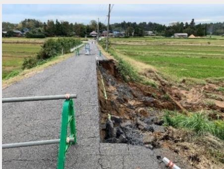
道路崩落した谷当橋付近 （内田～千城台駅）
