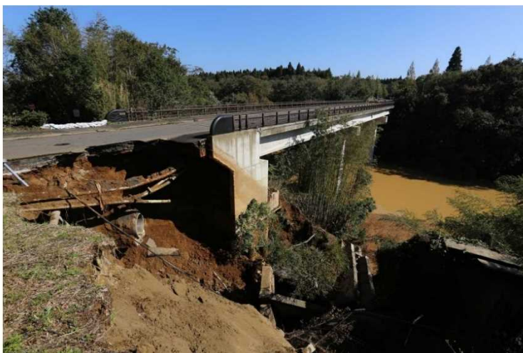
土砂崩れが発生した明神橋 (西御門)
