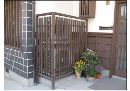
■写真 木材による囲いにより建築設備を修景した例（市外）
