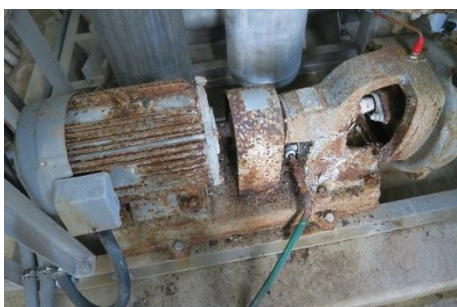
▲機械設備の錆(臼井中)
