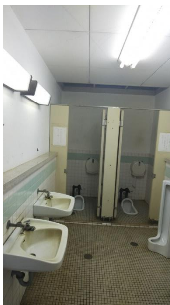
故障で使用不可の水道(右) 和式便器が並ぶトイレ(左)
