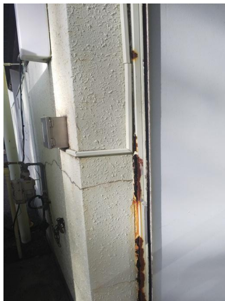
建屋外壁のひび、ドア枠のサビ
