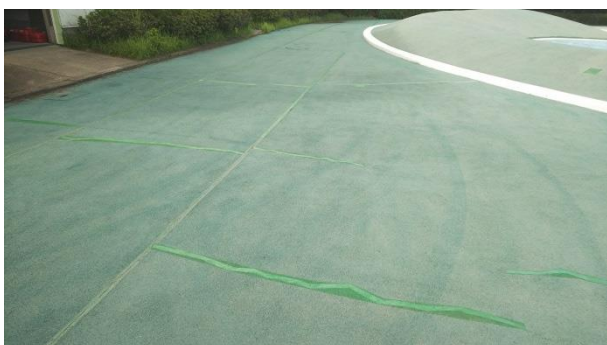
プールサイド床面の補修跡
