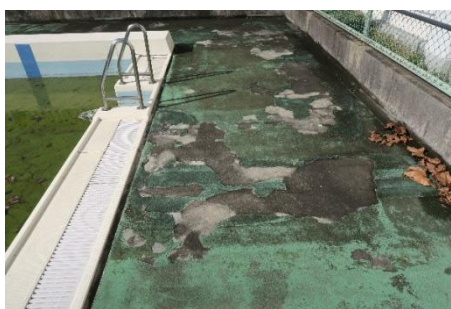
▲プールサイドの防水層の剥がれ (志津小)
