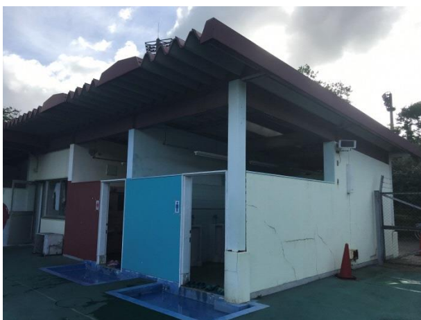
老朽化した屋外トイレ
