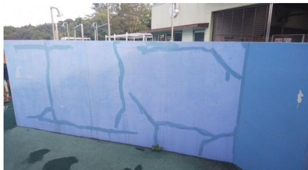
ひび割れの補修跡
