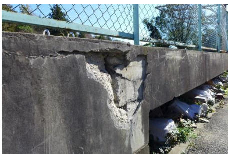
▲コンクリートの爆裂、鉄筋露出 (南志津小)
