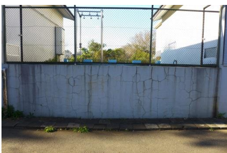
▲基礎コンクリートの全面的な ひび割れ(上志津中)
