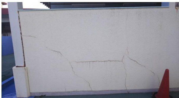
屋外トイレ外壁のひび割れ
