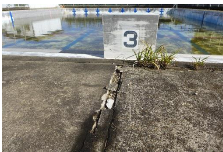
▲コンクリートひび割れ、雑草繁茂 シーリング材の劣化(根郷小)
