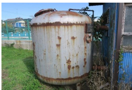
▲ろ過設備の錆、野外に設置 (臼井小)
