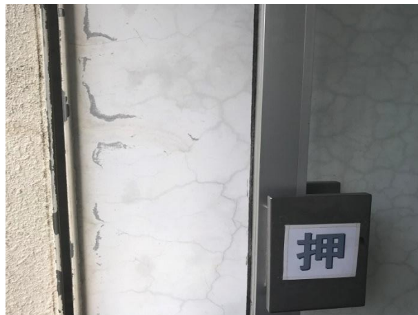
コンクリートのひび割れ
