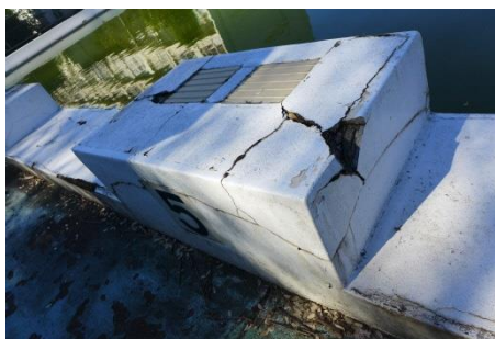
▲飛び込み台のコンクリートの爆裂 (南志津小)
