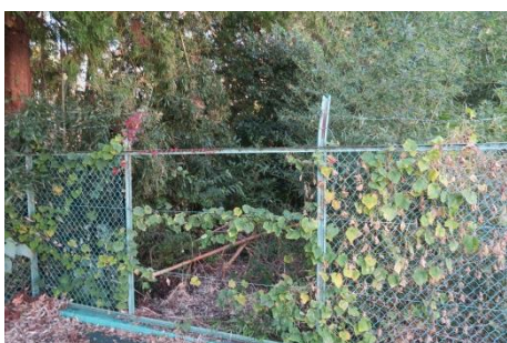
▲フェンスの破損(南部中)
