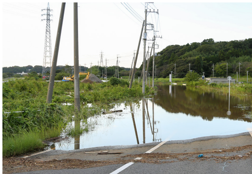
▲冠水した道路
