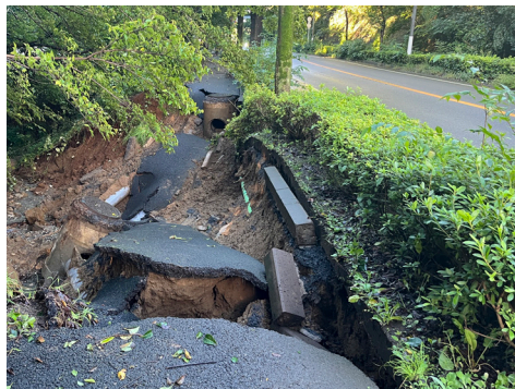
▲土砂崩れが発生した道路
