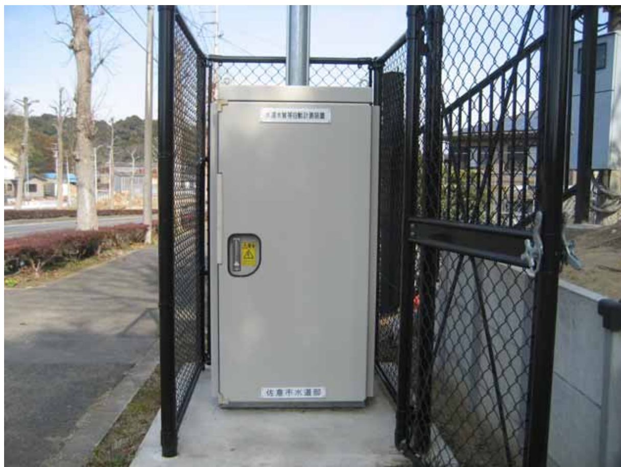
水道水質等自動計測装置
