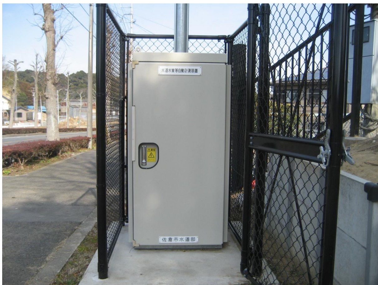
水道水質等自動計測装置
