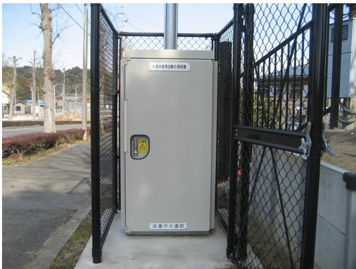
水道水質等自動計測装置
