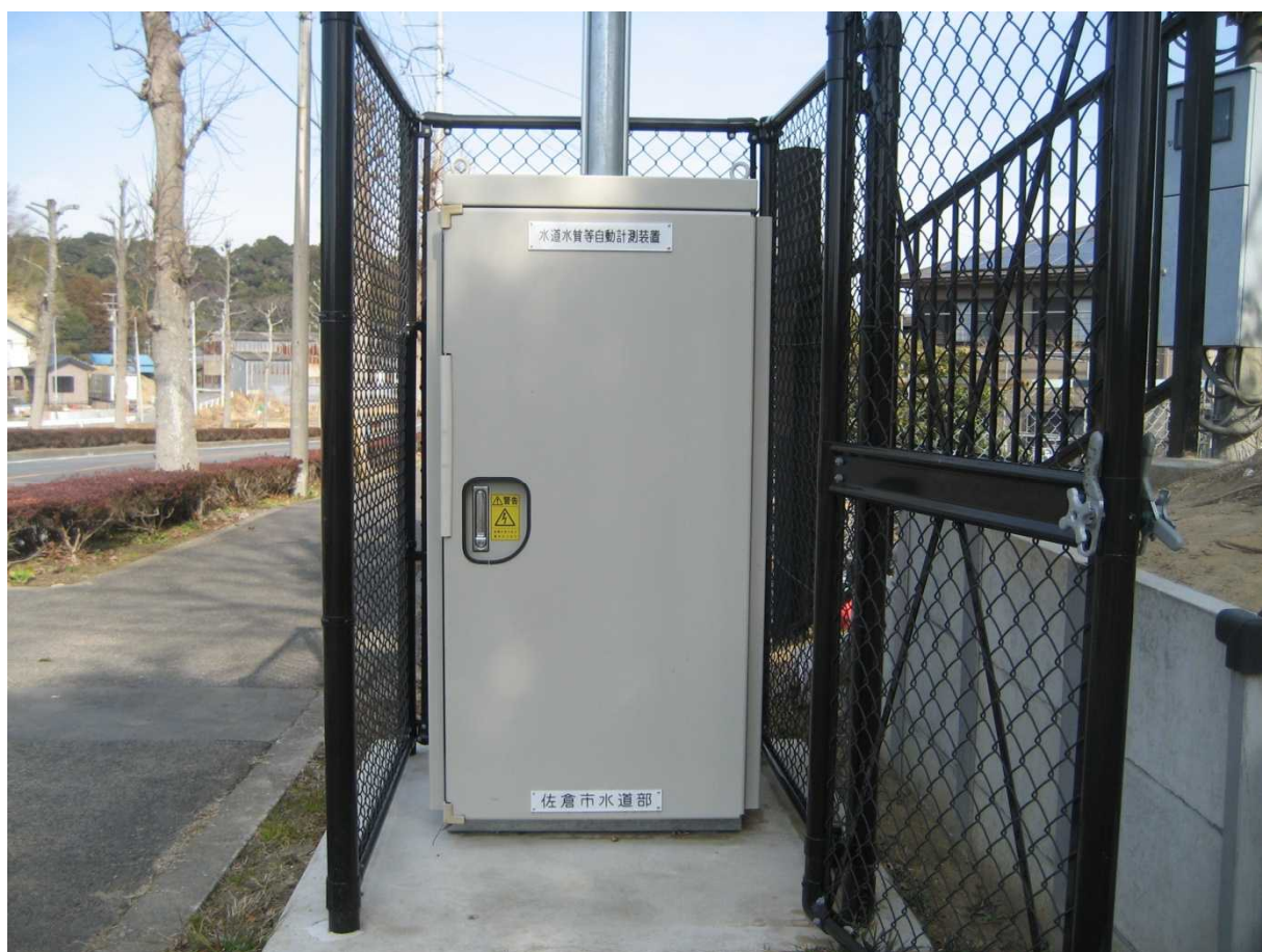
水道水質等自動計測装置
