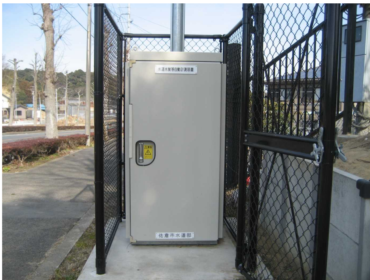
水道水質等自動計測装置
