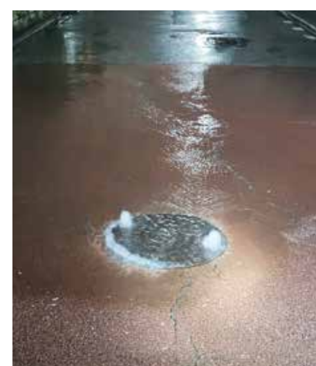
大雨時にマンホールから 下水があふれ出る様子
