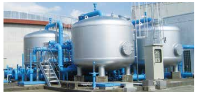
浄水場 除鉄・除マンガン装置
