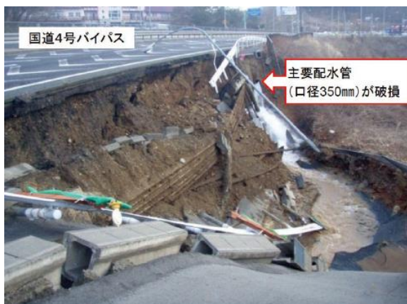
図4-4 東日本大震災で破損した水道管 (福島市水道局営業企画課提供)
