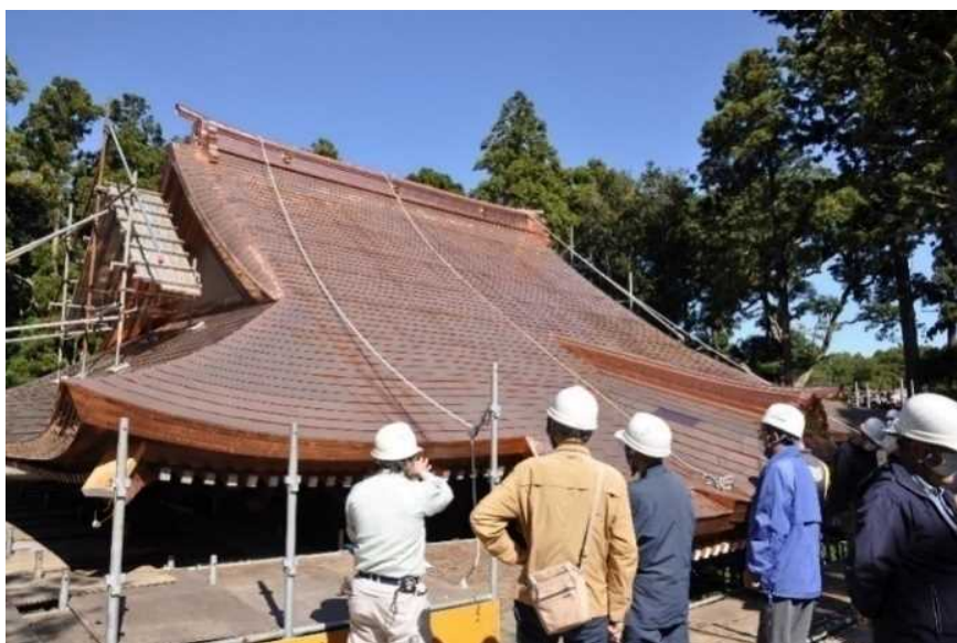
No.1-6 その他の歴史的建造物の 保存整備 (密蔵院薬師堂修復)
