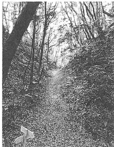
曲輪法面の崩落と堀切の埋土
