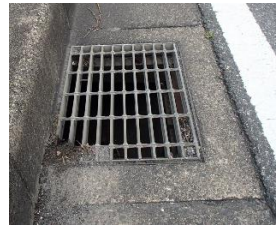
写真 グレーチング
